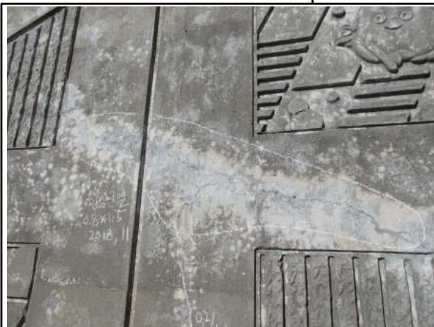
내 용 시점부 좌측옹벽 망상균열 16-2
