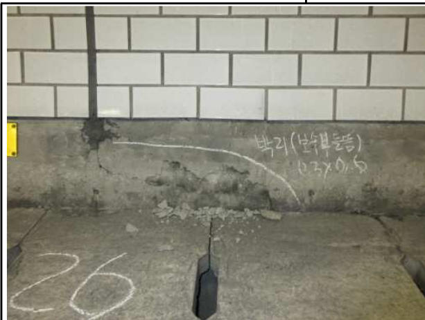
내 용 27Span 벽체 박리(보수부 들뜸) 6-5
