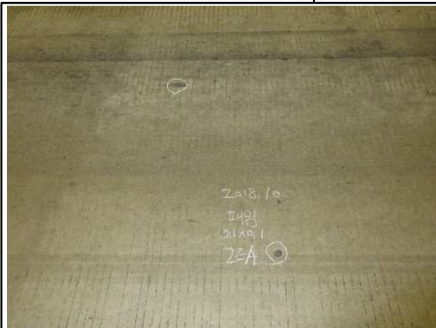
내 용 28Span 포장부 포장 패임 6-15
