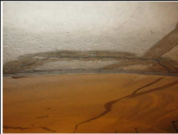
내 용 48Span 천단부 박락 10-13
