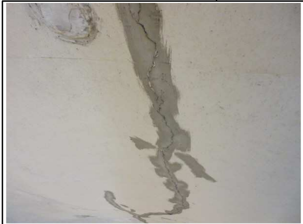
내 용 72Span 천단부 중방향 보수부 재균열 15-3
