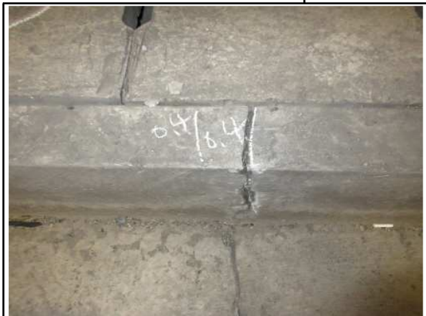
내 용 27Span 공동구 횡방향 균열 6-11
