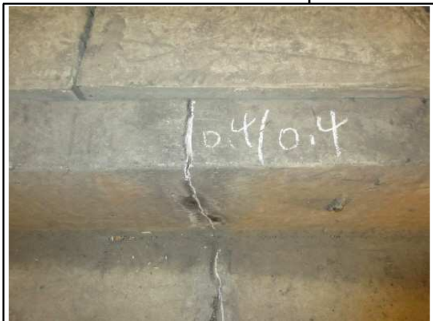
내 용 58Span 공동구 공동구 균열 12-10
