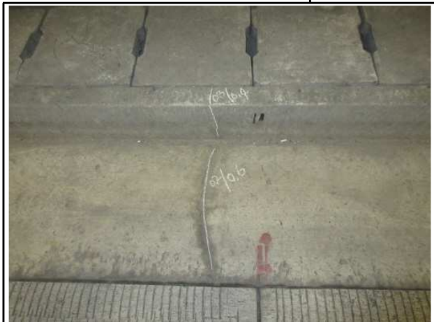
내 용 38Span 배수로 횡방향 균열 8-15
