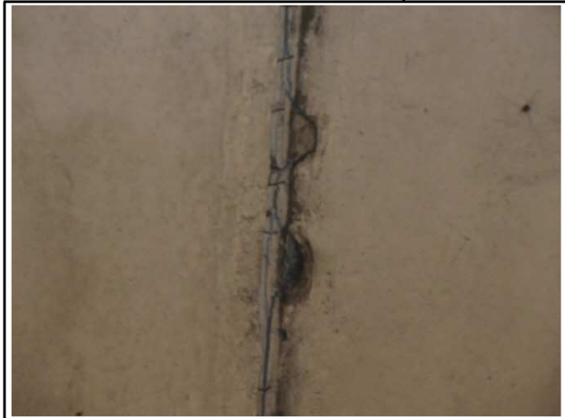
내 용 53Span 천단부 박락 11-2
